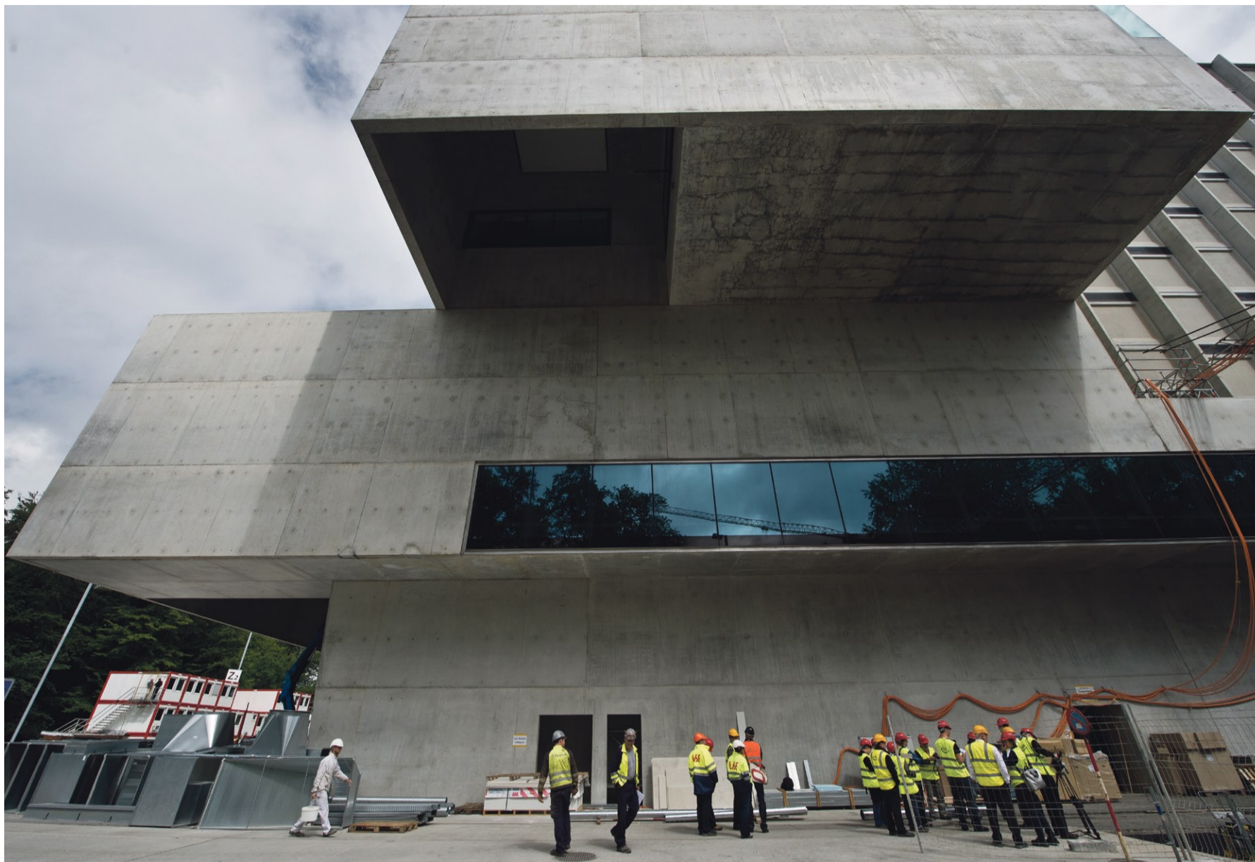
Ein Baustein für die Energiewende der Stadt Bern: Die neue KVA und Energiezentrale im Forsthaus. Foto: Adrian Moser
